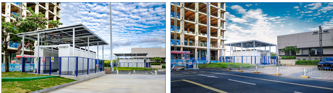
图表22：纳晖储能深圳龙岗万达4MWh储能项目
